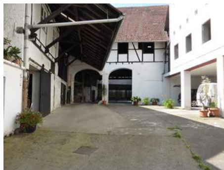
Abb. 40: Rückwärtiges Gebäude mit teilweise erheblichen Mängeln
