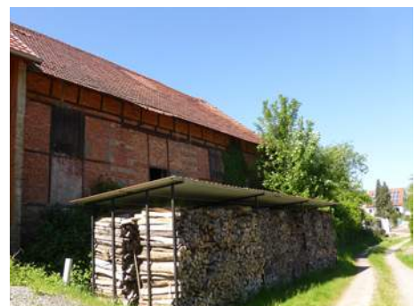
Abb. 41: Rückwärtiges Gebäude mit erheblich substantiellen Mängeln
